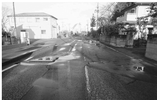
路面の傷みが激しい高瀬街道
