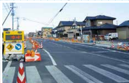
（2011〔平成23〕年3月28日撮影） 時が止まった国道114号
