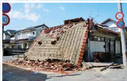
【権現堂地区】（2011〔平成23〕年3月12日撮影） 2階屋根が崩れ落ち、道路を覆っている。
