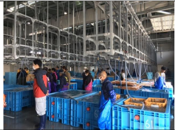
荷捌き施設内 活魚水槽
