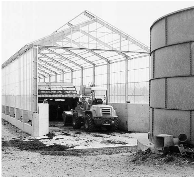
循環型農業の核となる堆肥センター
