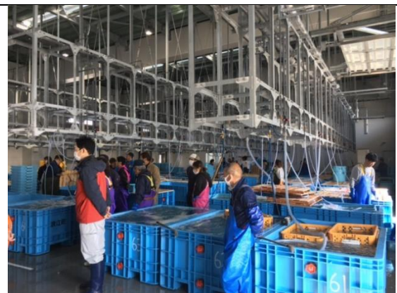
荷捌き施設内 活魚水槽
