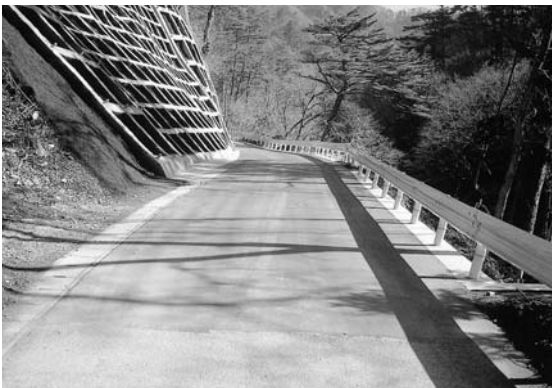
土砂災害 県道 253 落合浪江線南申瘤地内 (H17年8月)
