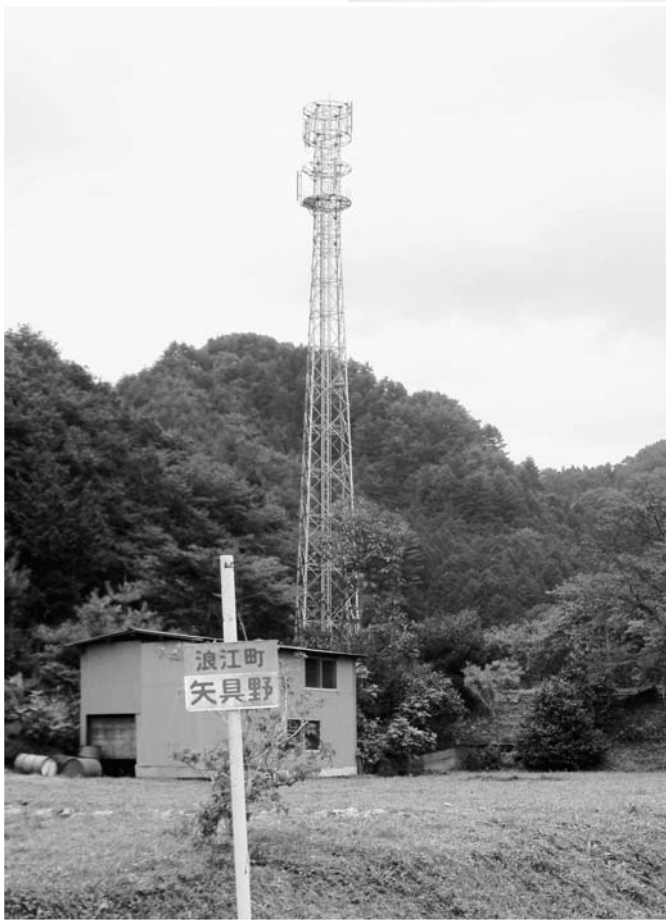
携帯電話通信鉄塔
