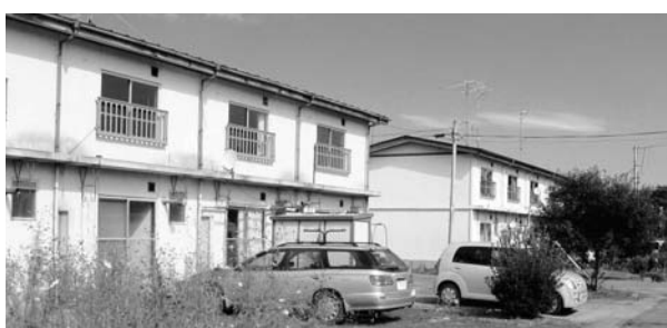
老朽化が進む町営住宅（南上ノ原住宅）
