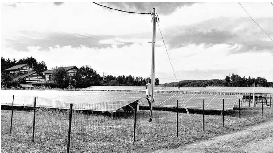
太陽光発電施設
