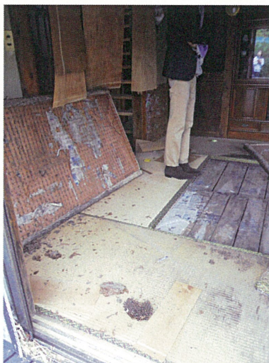
床の腐食 (2013 年 5 月 11 日撮影)
