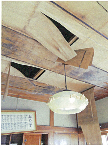
天井の崩落（2013年5月11日撮影）
