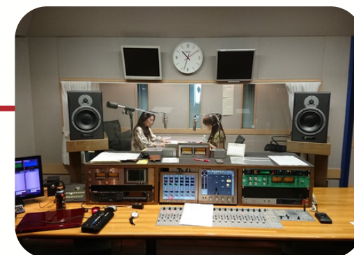
コントロールルーム
