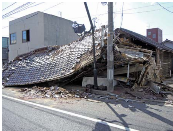
【権現堂地区】（平成23年3月12日撮影） 家屋の倒壊により街灯の傾き、道路へ屋根の崩れが生じている。
