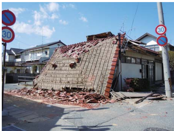
【権現堂地区】（平成23年3月12日撮影） 2階屋根が崩れ落ち、道路を覆っている。
