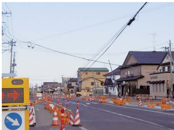
時が止まった国道114号 （平成23年3月28日撮影）
