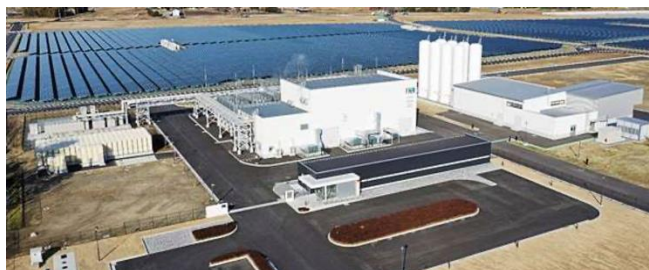
世界最大級の水素製造施設「福島水素エネルギー研究フィールド（通称FH2R）」を整備
